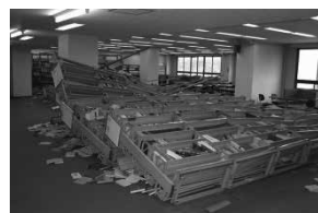
国際・教養系図書室の倒壊した書架
